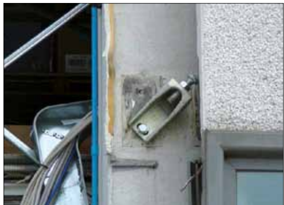
Figura 5.30: Rottura attacco mensola di supporto pannello e conseguente crollo del pannello. Livello di danno nella connessione pannello-struttura: D5 (terremoto Emilia-Romagna 2012)
