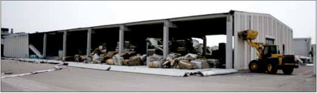
Figura 5.39: Caduta dei pannelli prefabbricati di tamponamento verticali a causa della rottura delle connessioni con la struttura poste in sommità. Livello di danno: D5 (terremoto Emilia-Romagna 2012, Sant'Agostino, FE)
