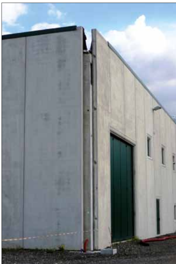
Figura 5.35: Caduta del pannello verticale d'angolo per rottura del collegamento in sommità. Livello di danno nella connessione pannello-struttura: D4-D5 (terremoto Abruzzo 2009).
