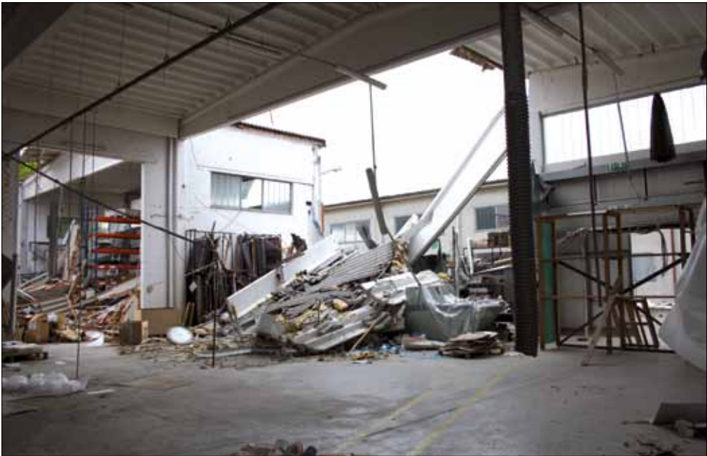
Figura 5.14: Perdita d'appoggio della trave di copertura dell'ampliamento di un capannone e conseguente collasso a taglio della stessa in corrispondenza della sua mezzeria. L'appoggio ad attrito trave-mensola è privo di collegamenti metallici, ed è caratterizzato da una lunghezza insufficiente. Livello di danno nella connessione trave-pilastro: D4 - D5 (terremoto Emilia-Romagna 2012, San Felice sul Panaro, MO)
