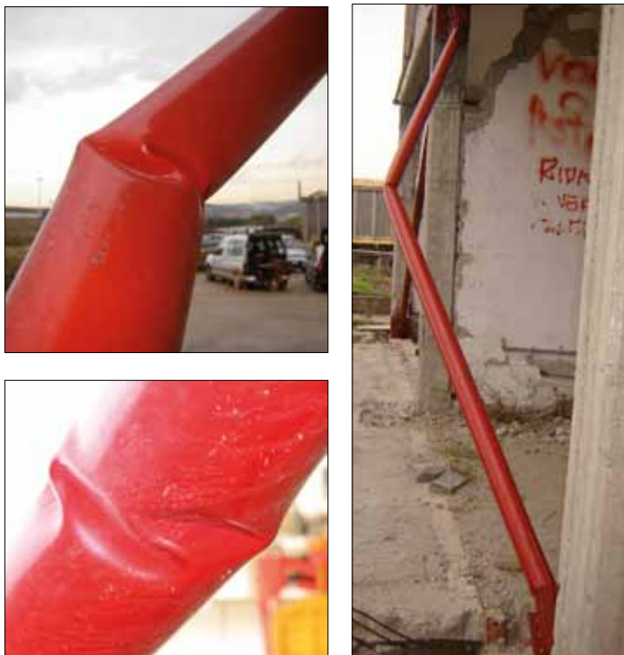
Figura 5.46: Esempi di danneggiamento dei controventi metallici: instabilizzazione legata ad un livello di danno D4
