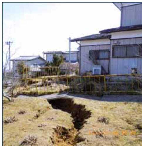
Figura 7.12: Collasso per instabilizzazione del terreno circostante un edificio residenziale a Midorigaoka (Sendai) (Giappone 2011)
