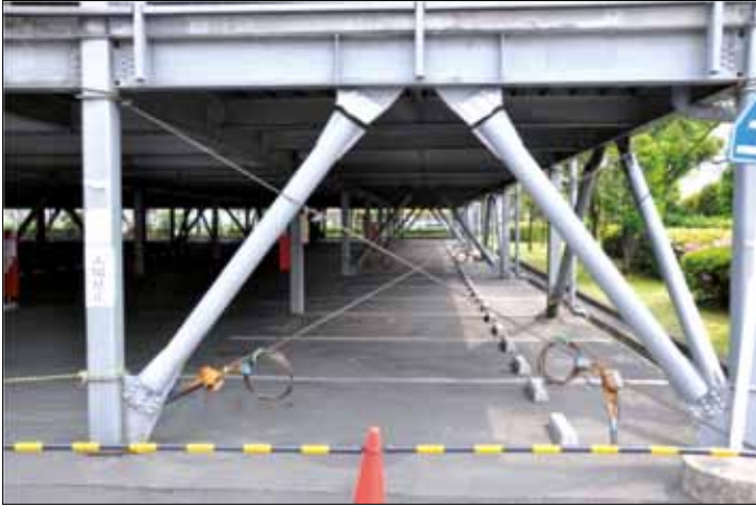
Figura 5.43: Rottura di entrambi i fazzoletti metallici in corrispondenza dell'attacco con i diagonal di controventamento di una struttura adibita a parcheggio. Livello di danno nel controvento: D4 - D5 (terremoto di Tohoku, Giappone 2011)
