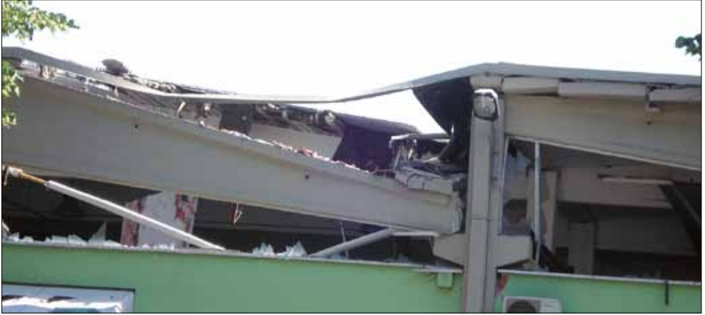
Figura 5.15: Perdita di appoggio della trave in un edificio monopiano prefabbricato con travi principali trasversali di non recente costruzione. Livello di danno nella connessione trave-pilastro: D4 - D5 (terremoto Emilia-Romagna 2012).
