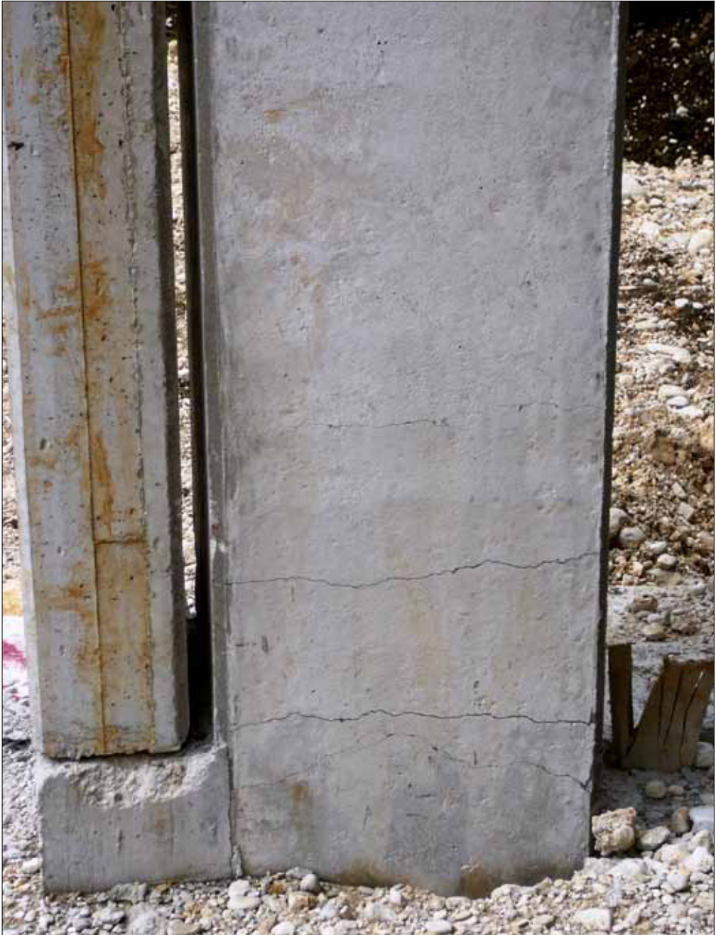
Figura 5.36: Danneggiamento locale alla base del pilastro e del pannello. Livello di danno nella connessione pannello-struttura: D3 (terremoto Abruzzo 2009).
