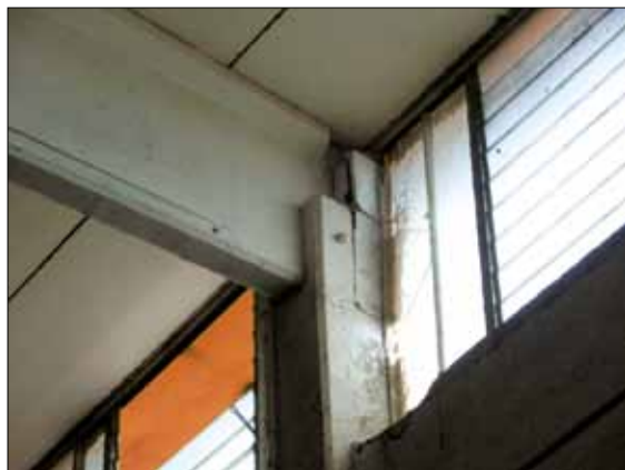
Figura 5.21: Danneggiamento della forcella del pilastro, dotata di perno di collegamento, in corrispondenza della trave. Livello di danno nella connessione trave-pilastro: D4 (terremoto Emilia-Romagna 2012, San Felice sul Panaro, MO)
