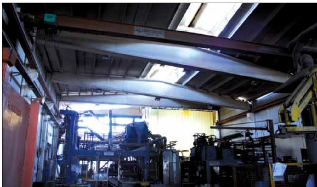
Figura 5.22: Perdita d'appoggio delle travi di copertura di un capannone prefabbricato monopiano. Livello di danno nella connessione trave-pilastro: D4 - D5 (terremoto Emilia-Romagna 2012, San Felice sul Panaro, MO)
