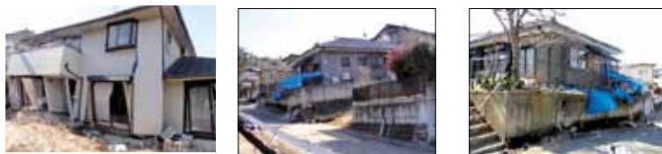
Figura 7.3: Danneggiamento di un edificio (a sinistra) e danneggiamento dei muri di contenimento (al centro e a destra) causati dallo scorrimento del terreno - Oritate 5-chōme (Giappone 2011)
