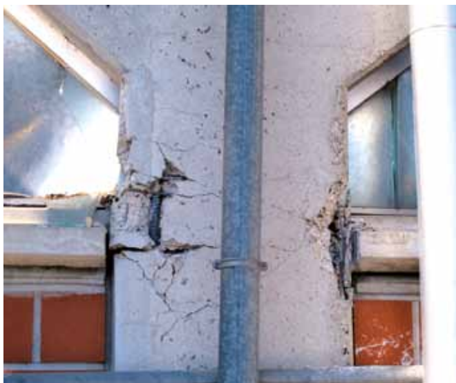
Figura 5.5: Danneggiamento di un pilastro tozzo a causa della presenza di una finestra a nastro lungo i tamponamenti in muratura, che ne determina un'irregolarità nella distribuzione di rigidità in elevazione. Livello di danno nel pilastro: D4 (terremoto Emilia-Romagna, 2012)
