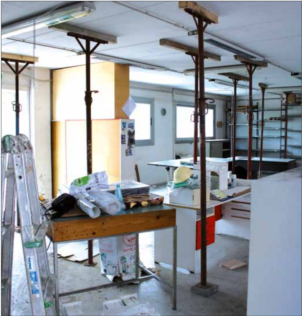
Figura 5.48: Puntellatura di un solaio di un blocco aggiunto interno in seguito al danneggiamento della connessione tra orizzontamento e struttura verticale. Livello di danno complessivo: D3 (terremoto Emilia-Romagna 2012, San Felice sul Panaro (MO))
