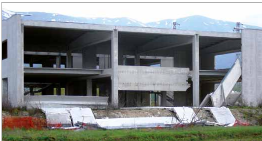
Figura 5.28: Perdita d'appoggio di elementi di solai prefabbricati e caduta dei pannelli. Livello di danno nella connessione pannello-struttura: D5 (Terremoto Abruzzo 2009, L'Aquila)
