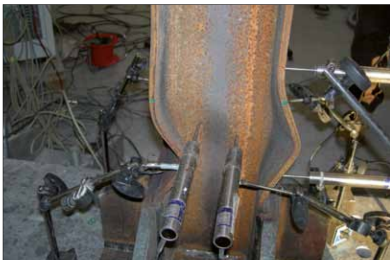
Figura 5.47: Strutture in acciaio, esempio di danno gravissimo dovuto a plasticizzazione flessionale con instabilità locale: livello di danno D4.
