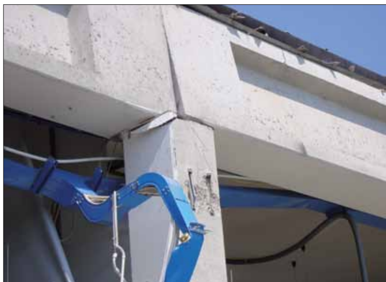
Figura 5.18: Inadeguatezza del vincolo trave-pilastro nei confronti della rotazione fuori piano della trave di copertura con danneggiamento locale del pilastro e rotazioni permanenti della trave. Livello di danno nella connessione trave-pilastro: D4 (terremoto Emilia-Romagna 2012)
