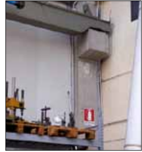
Figura 5.8: Martellamento tra trave porta-carroponte e pannello tagliafuoco di compartimentazione tra zona produttiva e zona uffici di un capannone industriale. Livello di danno: D2 – D3 (terremoto Emilia-Romagna 2012)
