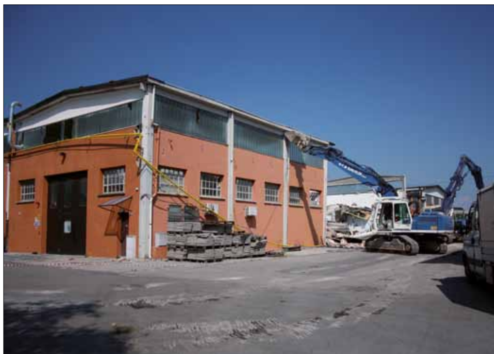
Figura 5.50: Demolizione in seguito al crollo di una parte dell'edificio (terremoto Emilia-Romagna 2012, San Felice sul Panaro (MO))
