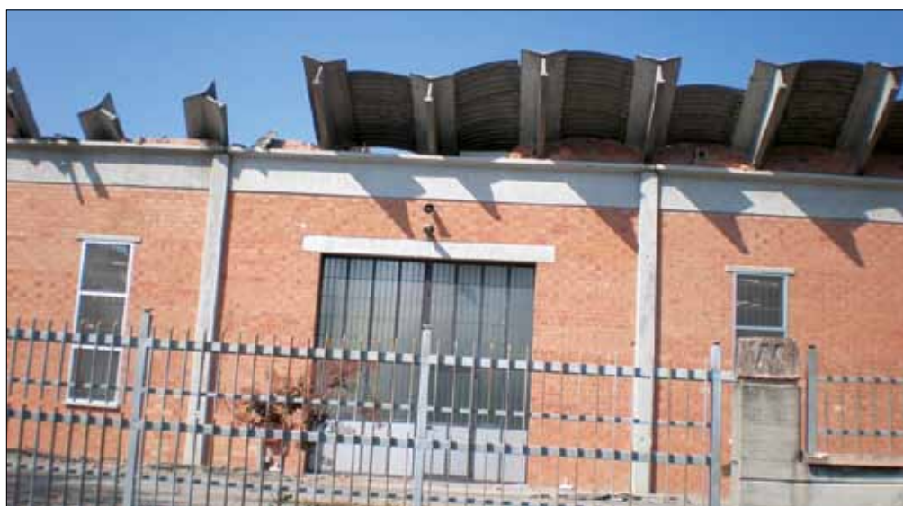
Figura 5.26: Collasso della copertura con tegole ad Y. Livello di danno nella connessione copertura-trave: D5 (terremoto Emilia-Romagna 2012)
