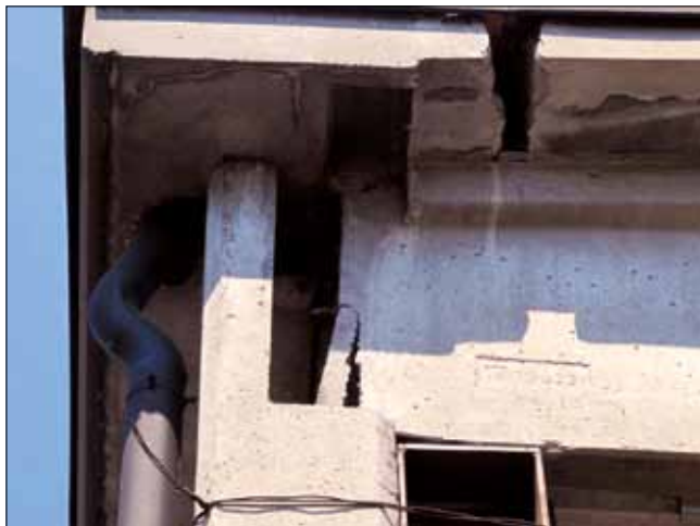
Figura 5.17: Perdita quasi completa dell'appoggio della trave di copertura e rottura locale dovuta a scarso dettaglio di armatura in testata. Livello di danno nella connessione trave-pilastro: D4 (terremoto Emilia-Romagna 2012)
