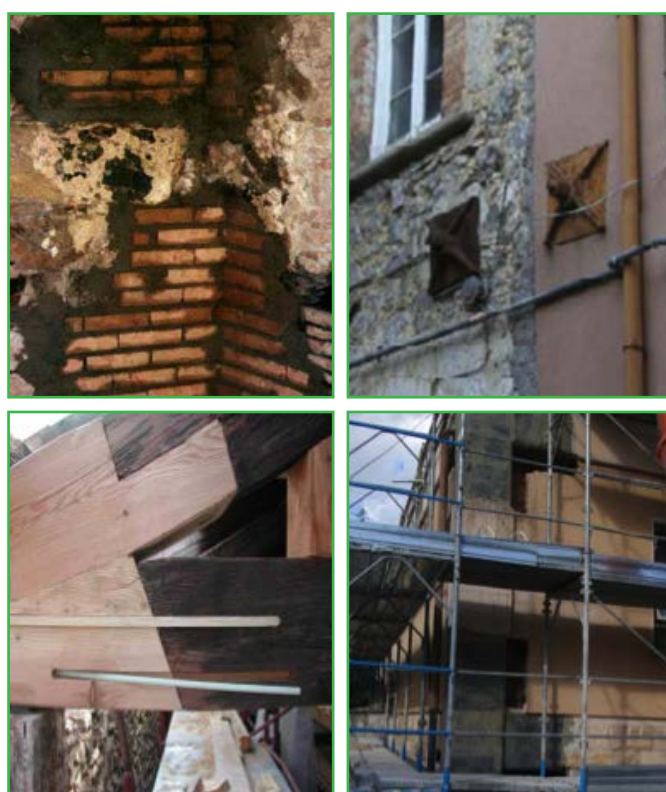
Figura 19. Esempi di intervento (cucì e scuci; capichiave a piastra, rinforzo trave lignea, e fasciature mediante fibre di carbonio) (DPC – ReLUIS, 2011).
