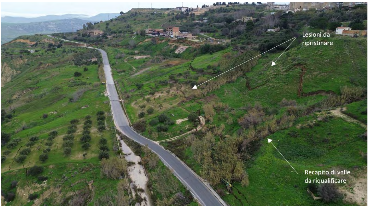
Figura 19 - Recapiti di valle da riqualificare ed evidenza sulle lesioni da ripristinare.
