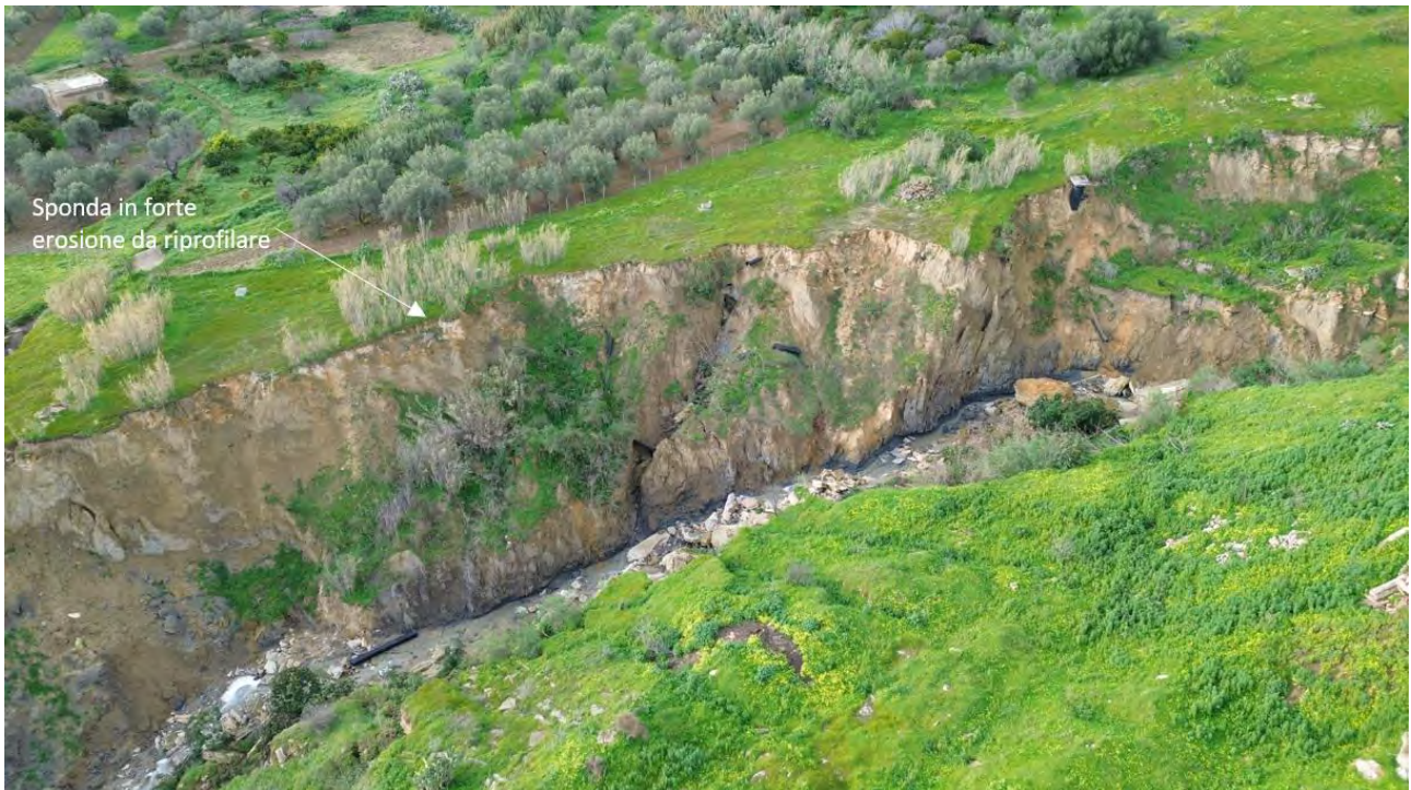
Figura 73 - Sponda in destra idraulica al torrente Benefizio in forte erosione, da riprofilare mediante impiego di gabbioni e sistemi di protezione dall'erosione superficiale
