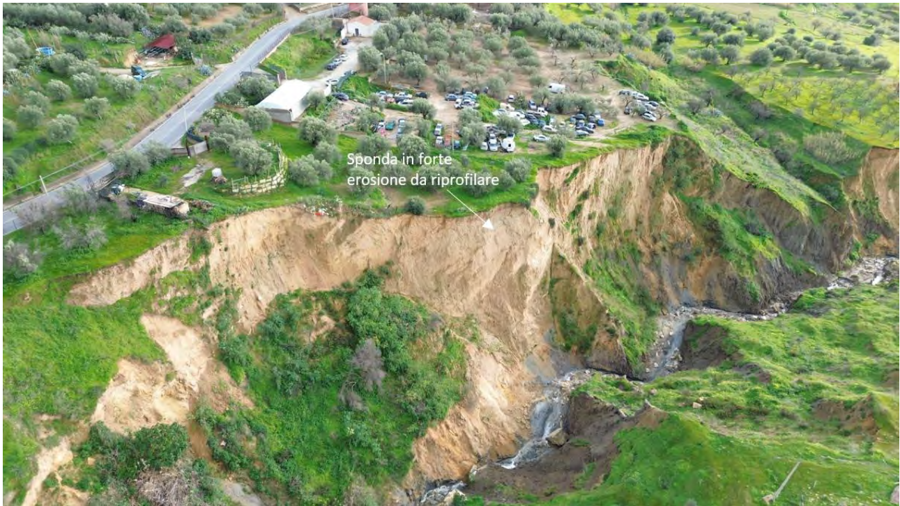
Figura 77 - Sponda in sinistra idraulica al torrente Benefizio in forte erosione, da riprofilare mediante impiego di gabbioni e sistemi di protezione dall'erosione superficiale.
