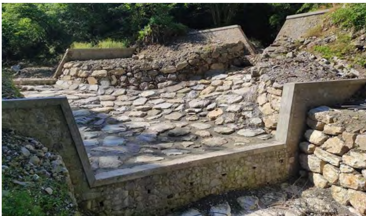
Figura 69 - Briglia in calcestruzzo armato su fondazioni profonde - Solco del Diavolo, Alta Garfagnana (LU).
