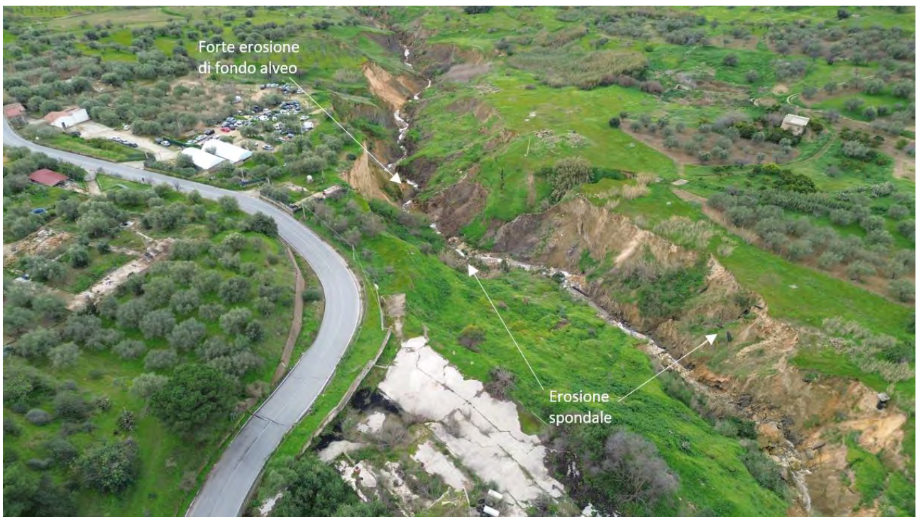
Figura 64 - Alveo e superfici spondali del torrente Benefizio in evidente stato di erosione e dissesto diffusi.
