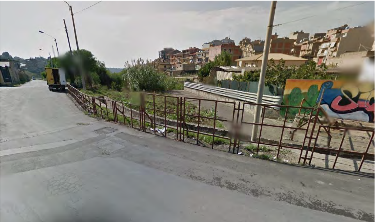
Figura 81- Canale esistente di scarico in c.a. a sezione aperta nel torrente Benefizio.
