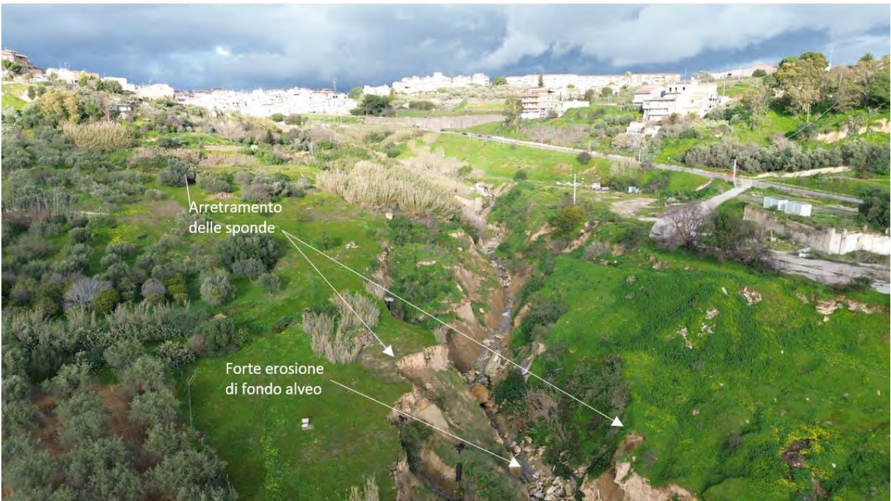
Figura 658 - Alveo e superfici spondali del torrente Benefizio in evidente stato di erosione e dissesto diffusi, con evidenza della forte pendenza longitudinale del fondo alveo.
