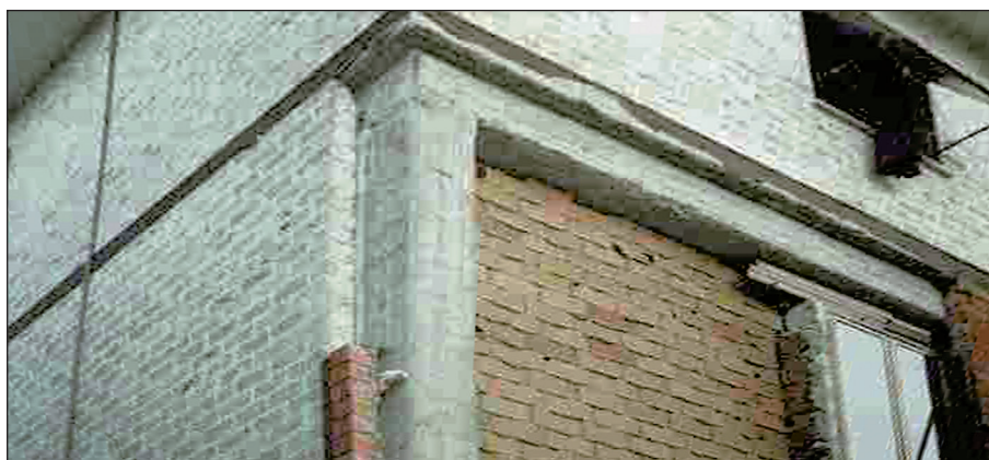
Figura 10. Esempio di dissimmetrie delle tamponature (Manuale AeDES).
